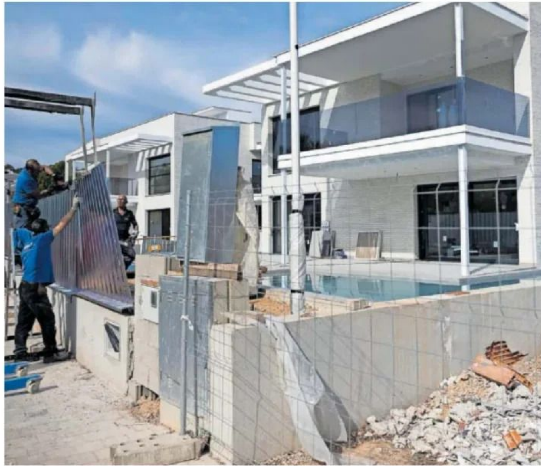
Unos obreros trabajaban en la construcción de viviendas, el miércoles en Sitges. ALBERT GARCIA
